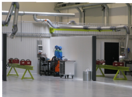
Offshoreindustri: Welltec, Esbjerg Svejsersugsudsug 9.000m³/h
