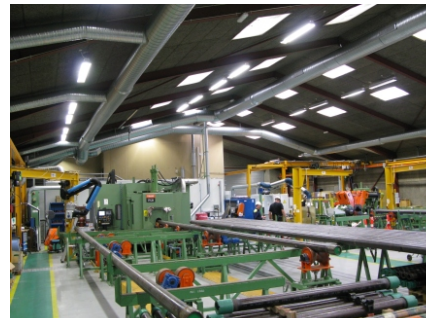
Offshoreindustri: Tenaris, Esbjerg Ventilation i fabriksdal 14.000 m³/h
