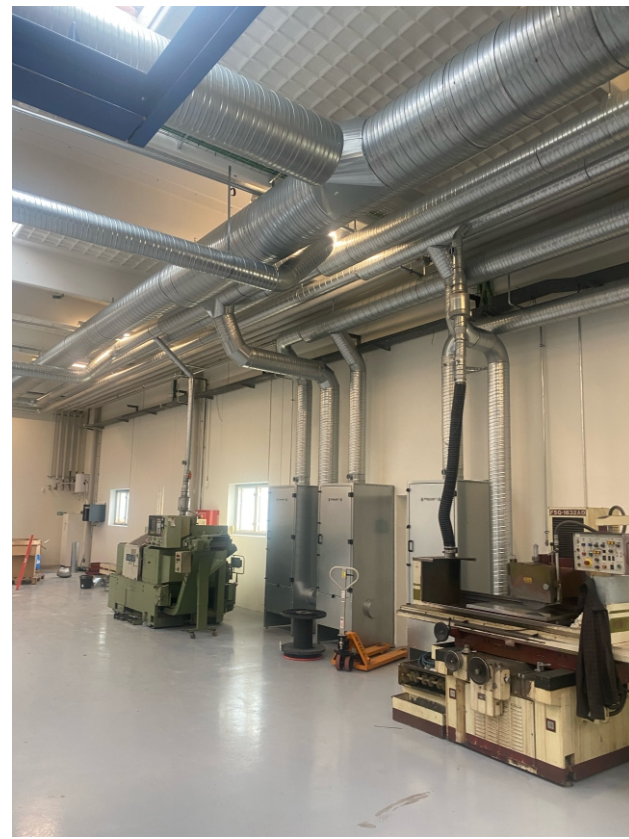
Etablering af olietågefilter for procesudsugning fra i alt 16 maskiner i ny produktionshal.
