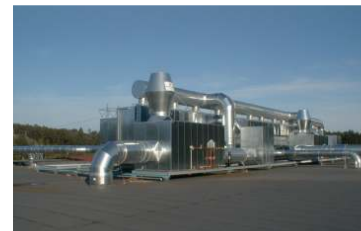
En procesluftkanal ført gennem krydsvarmeveksler
