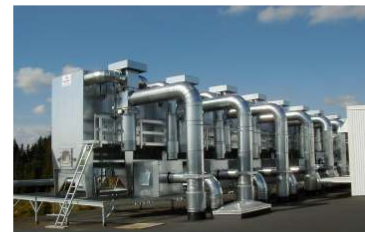
En procesluftkanal pr. sektion
