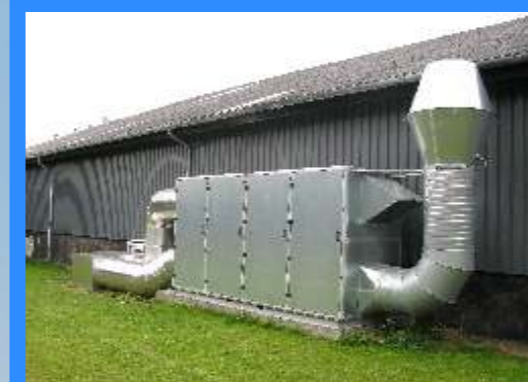
Ventilationsaggregat placeret udenfor tilsluttet eks. fjernvarme
