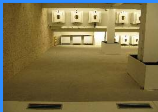
Udsugning i gulv foran skytten, for at trække luften væk fra skytten.
