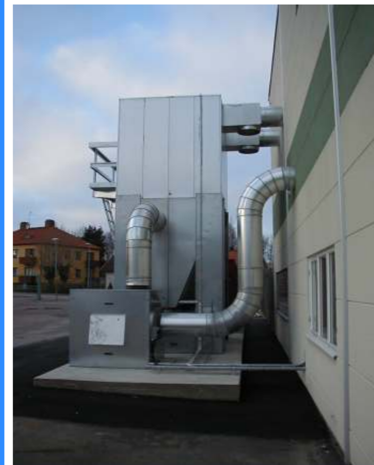
Returluft ført tilbage til lokalet
